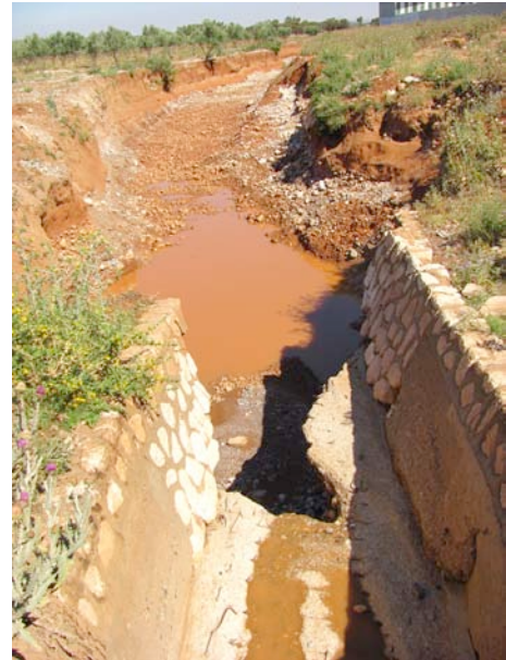
Photo 16. Ouvrage détruit par les crues en aval du pont de la route de Marrakech.
