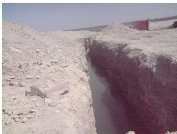
Photo 10. Canal d'évacuation de la crue de l'oued Bou Rkaiz
