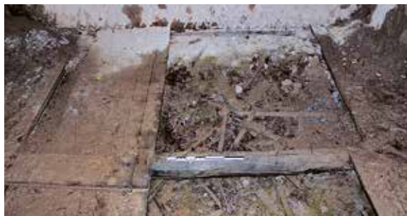
Fig. 3. Plancher du sas d'une baraque. Quelques lames ont été arrachées et laissent voir les solives. La couche de boue sur le plancher provient de l'isolation en terre des parois.
