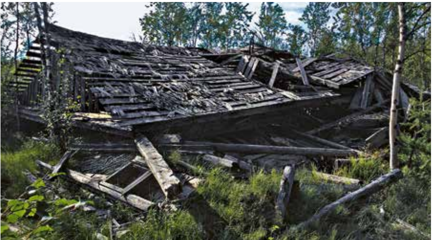
Fig. 6. Toit effondré du bâtiment administratif ouest (B7).
