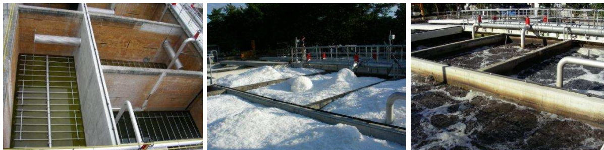
Figure 9 : à gauche : bassins du lit fluidisé vide, avec les tuyaux perforés pour l'aération et les crépines pour retenir les supports ; au milieu : problèmes de débordements des supports lors du remplissage des bassins ; et à droite : lit fluidisé en fonctionnement normal.
