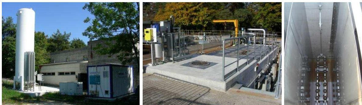
Figure 10 : à gauche : citerne d'oxygène avec le container du générateur d'ozone ; au milieu : réacteur d'ozonation avec le destructeur d'ozone ; et à droite : vue d'un compartiment du réacteur avec une des rampes d'injection.
