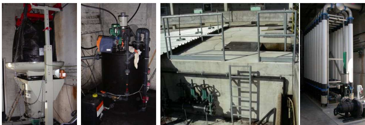
Figure 11 : Photo 1 (à gauche) : « big bag » de CAP sur un support vibreur qui amène la poudre dans le bac de préparation de la solution de CAP (photo 2) ; photo 3 : réacteurs de contact du CAP avec les eaux usées ; photo 4 : membranes d'ultrafiltration pour la séparation du CAP.
