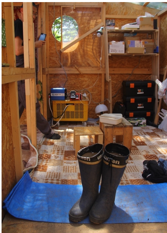
Figure 24 : Intérieur de la cabane principale avec, au fond, l'onduleur (boîtier bleu à gauche) et les batteries (boîtes noires à droite). Sapporo, juin 2017.
