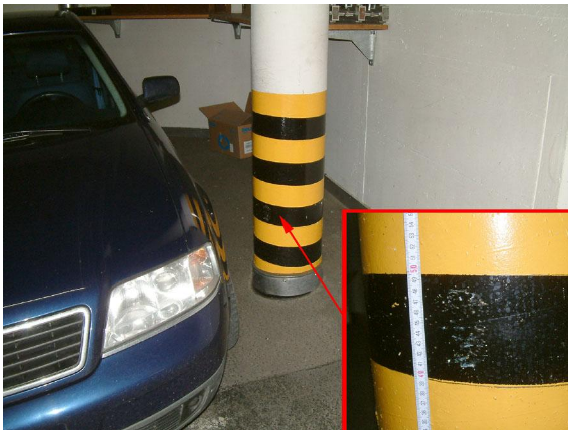
Figure 96 : Mise en évidence de traces de peinture bleue sur un pilier, à proximité de la place de parc du véhicule
