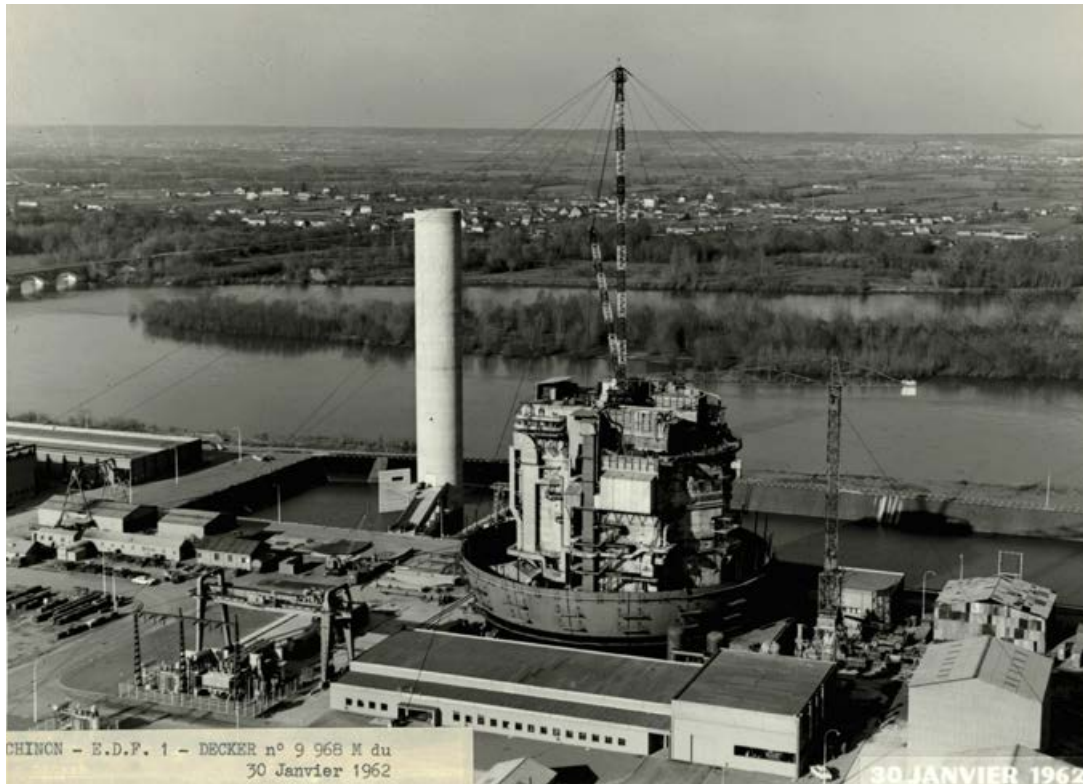
Chantier de la centrale nucléaire de Chinon A1, 30 janvier 1962. © EDF - Archives/Photo M. Béranger
