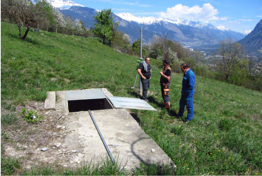
FIGURE 3.27 – Installation de monitoring sur le réseau d'irrigation en amont du vignoble : chambre de la vanne coupe-pression où est installée la sonde débitmètre.
