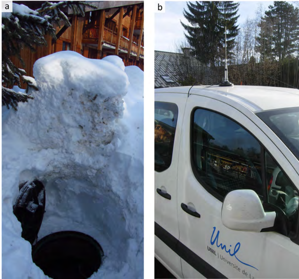
FIGURE 3.31 – Regard dégagé de la neige (a) et antenne réceptrice utilisée pour la relève à distance des compteurs d'eau équipés d'émetteurs radio (b). Photographies : février 2015.
