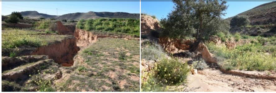
Figure 5. Echantre ouverte dans une tabia, prolifération du ravinement dans la surface d'un Jesr et déchaussement des implantations.
