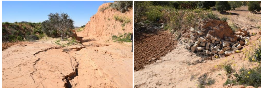
Figure 6. Alluvions colmatant partiellement la surface d'un Jesr et culée de pierres sèches démolie par le ruissellement détruisant le déversoir.
