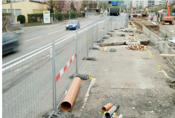
FIG. 6.7: Vue générale des lieux de l'accident lors du relevé des lieux.
