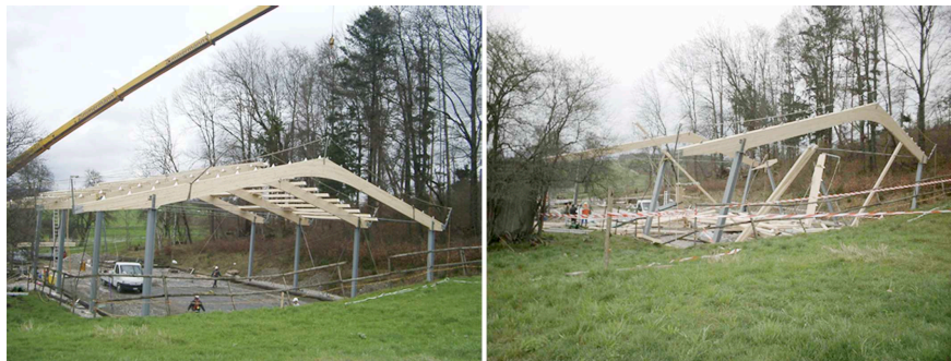
FIG. 5.6: Vue générale des lieux de l'accident. A gauche une image de témoin, juste avant l'effondrement. A droite, une vue des lieux après l'effondrement. Image fournie par le WD/UTD de la police de la ville de Zurich.
