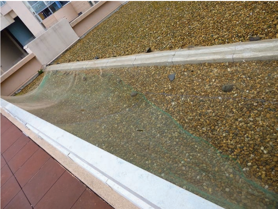
Figure 2: Un filet installé contre les goélands sur une terrasse à Sète (Paulet, 2018).
