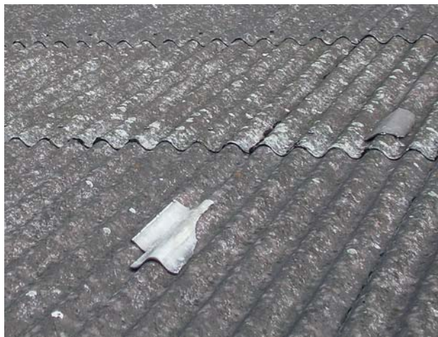
III. 21: Dompage grêle typique sur un toit en eternit ondulé : les grêlons ont provoqué des éclatements et des fissures (non visibles sur la photo) (photo : ECA d'Argovie).
