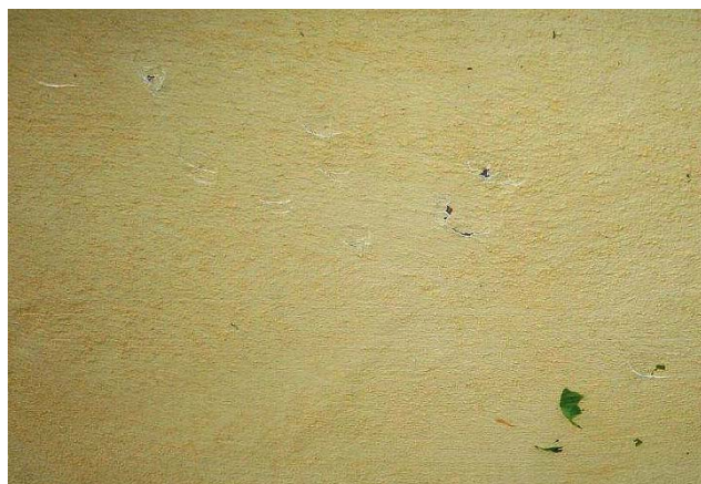
III. 20: dompage grêle typique sur une façade : fissures et éclatements dans le crépi (photo : ECA d'Argovie)
