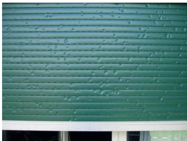
III. 19: Dompage grêle typique sur un volet roulant : les grêlons ont provoqué des bosses bien marquées (photo : ECA d'Argovie).
