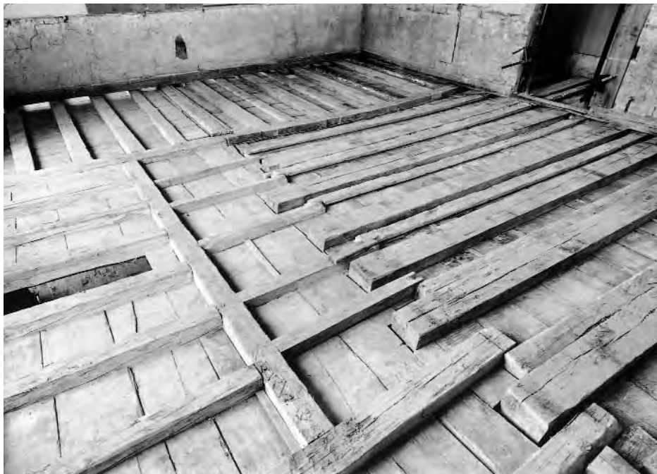
1073. Salle 305, Vue sur les planchers de la salle 306, en direction du nord. Etat en 1990. L'aspect très composite de ces structures s'explique par la progressive occupation dès 1650 du niveau inférieur. Au fur et à mesure de leur apparition, les chambres ont formé des sortes de caisses en bois qui se sont juxtaposées. Les poutres les plus fortes ont été posées en 1883 pour l'aménagement de salles de classe. Ces structures n'ont pas pu être conservées pour répondre aux normes de sécurité qu'exigeait l'espace public de la future salle d'exposition. (Fibbi-Aeppli)
