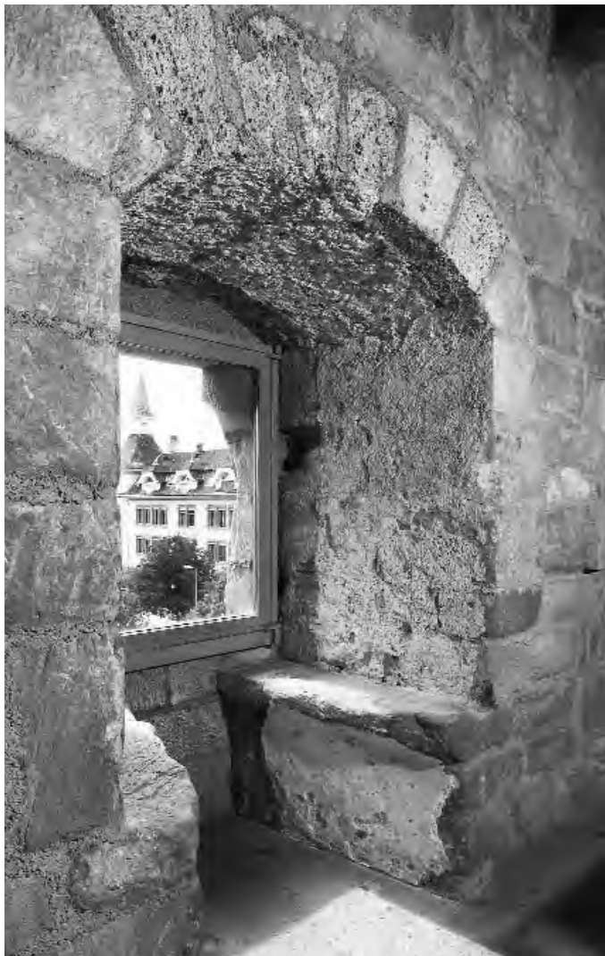
53. Château d'Yverdon, embrasure d'une des baies-créneaux desservies par le chemin de ronde de la courtine sud. Etat en 1997. Le jour proprement dit, ainsi que l'allège, ont été restitués par Pierre Margot lors de la restauration de 1974–1977. L'embrasure est originale; elle est sommée d'une voûte en arc surbaissé faite de claveaux de tuf. Elle dispose de deux coussièges en molasse recouverts par un enduit épais, assurément médiéval, peut-être remontant à l'origine du château. Ce fragment nous rappelle que tous les parements intérieurs et sans doute extérieurs du château étaient enduits, d'une teinte très blanche. (PBC-VD, Fibbi-Aeppli)
