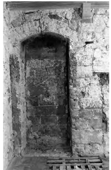
979. Château d'Yverdon, aile sud, ancienne salle «des armoiries» [120-5], vue sur la courtine sud, dans l'angle sud ouest de la pièce. Etat en 1961. La niche contenant le départ de l'escalier montant à la grande tour vient d'être mise au jour; son couverture fait de deux arcs de terre cuite alternant avec des blocs de molasse en réemploi, ne saurait refléter l'état médiéval, inconnu. À droite, on voit un des montants du contrecœur de la cheminée de la camera domini . (P. Margot)
