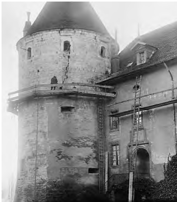
965. Château d'Yverdon, la tour des gardes en cours de décrépiage, fin 1918. Non seulement les percements anciens, mais d'importantes fissures sont mis au jour. (AFMH)
