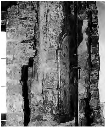
37. Château d'Yverdon, cellier sud [005]. Restes du contrefort renforçant l'angle sud-ouest de la chapelle, appuyé contre le mur primitif soutenant la cour intérieure. Etat en 1994. (Fibbi-Aeppli)
