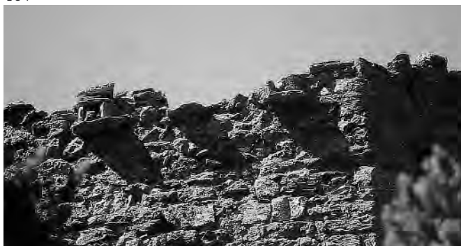
164. Oyace (Val d'Aoste). Grande tour octogonale, détail du couronnement vu de l'est. Le parapet crénelé a disparu. Trois gargouilles d'évacuation des eaux pluviales sont conservées sur cette face. Leur aspect est très proche de celles de la grande tour de Châtel-Argent. Etat en 1998. (D. de Raemy)
