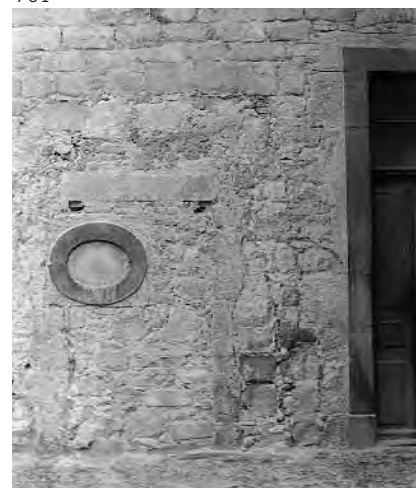
701. Château d'Yverdon, aile sud, façade sur la cour intérieure, partie ouest. Porte de 1700 donnant à l'origine dans la grande allée [120-1 à 4]. Etat après les décrépiages de 1956. Cette porte a remplacé l'accès direct depuis la cour à la nouvelle salle des armoiries; elle a été condamnée à la période scolaire, remplacée en 1841 par l'oculus éclairant la prison des écoles. À droite, la grande porte dans l'angle ouest de la cour, maintenant supprimée, remontait à ces mêmes travaux de 1841. (P. Margot)
