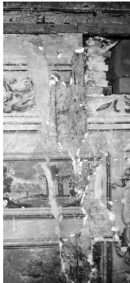
1045. Juin 1997, salle 109-2, paroi sud, détail. La mauvaise adhérence des crépis sur les parties de bois a requis des pontages d'urgence (tâches blanches).
