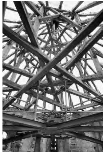
1079. Chantier de la réfection des couvertures, charpente de la tour nord de la Place. Etat en 1994. En dessous les profilés métalliques partant d'un point central et passant à travers les baies de 1610 ont supporté l'échafaudage qui avait pris l'aspect d'un hourd médiéval. (Fibbi-Aeppli)
