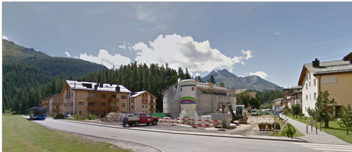
Image 32: site de construction de Pas-chs – vue en direction Sud-Ouest depuis le chemin Pas-chs, 2014
