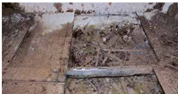
Fig. 3. Plancher du sas d'une baraque. Quelques lames ont été arrachées et laissent voir les solives. La couche de boue sur le plancher provient de l'isolation en terre des parois.
