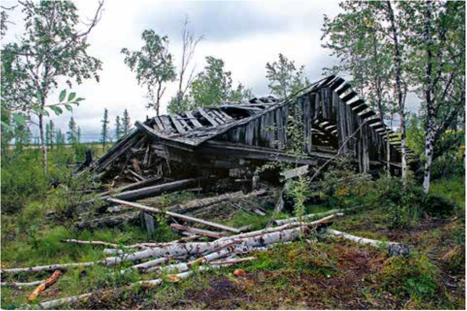
Fig. 3. Toit d'un bâtiment totalement effondré (B7)¹.
